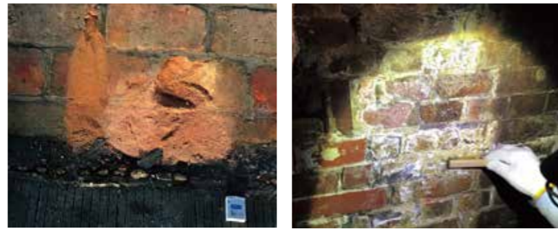
窯上部の塩類風化の様子 (風化が進み煉瓦が粉状になっている)
