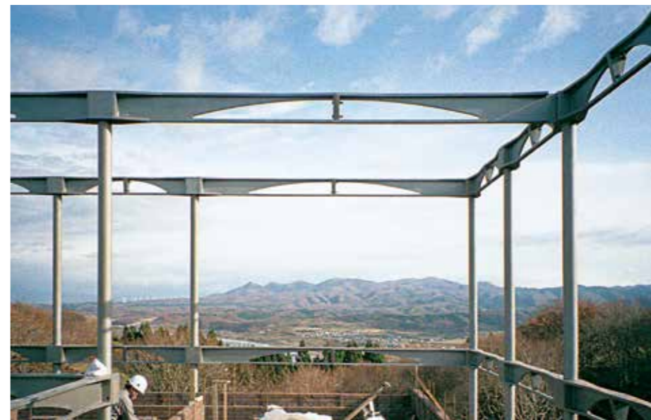
鉄骨によるフレームが組み立てられた状態 [提供：森川博史]
