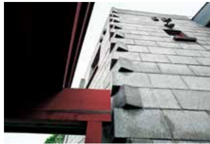
1 コンクリートブロックが鈍角に交わる外壁のディテール 2 冬の高柳邸。1階部分はほとんど雪に埋もれてしまうような天候でも、内部は暖かな空間が保たれる
