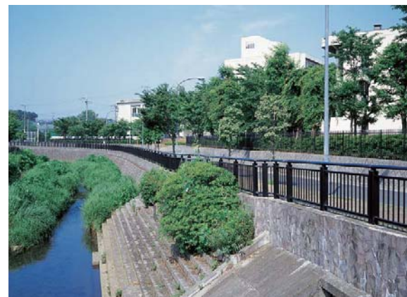
トップレール仕様の柵が、より安全性を高めます（横浜市和泉川）
