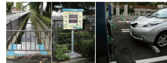
前橋市では市内全域で小水力発電の整備事業に取り組んでいる。市役所西側を流れる矢田川では小水力発電装置による電気自動車の充電スタンドが稼働中
