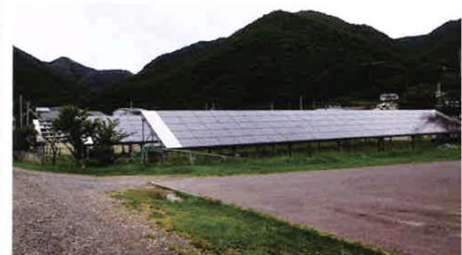
葛巻町立葛巻中学校太陽光発電設備。通年平均で同校の使用電力量の25%をまかなっている。校内には発電量が一目でわかるモニターが設置され、生徒の再生可能エネルギーや地球環境保全への意識向上にも役立っている
