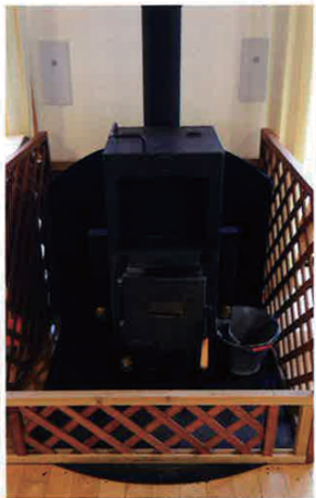
くずまきワイン工場に隣接する体験学習工房「森のこだま館」のペレットボイラーと館内に置かれたペレットストーブ。「森のこだま館」では50kWのペレットボイラー2基が、館内の暖房と給湯をすべて賄っている
