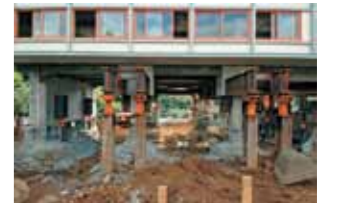
地下ホールの増築：2階床構造部から下部を解体しながら躯体工事を進めた[提供：三菱地所設計]
