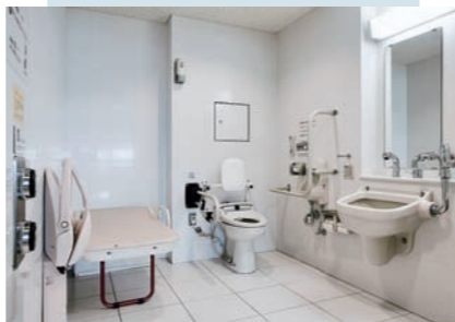
多目的トイレ ●INAX使用商品●オストメイト対応汚物流し：S-203U
