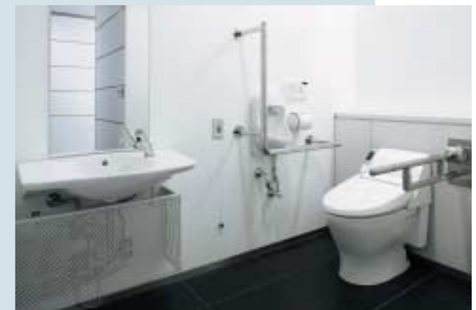
ユニバーサルトイレ ●INAX使用商品●センサー大便器：BC-950P-AY、DV-155F-RB-TU2、紙巻器：CF-A23D、手洗器：AWL-71AP（P）、洗面器：L-275FCR、自動水栓：AM-91（100V）
