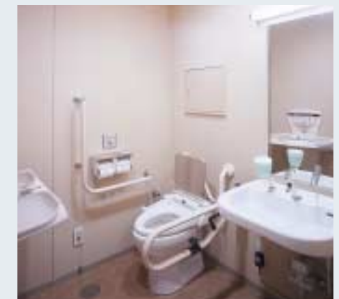
だれでもトイレ ●INAX使用商品●大便器：C-5KR、シャワートイレ：CW-P22F-NEC、自動フラッシュバルブ（埋込形）：OKC-581、タッチスイッチ：OKC-2BP、背もたれ：KFC-270T1、手すり：KF-470EH70、ステンレス手すり：KF-920ER50、洗面器：L-365、サーモスタット付自動水栓：AM-91K（100V）、水石けん入れ：KF-24B
